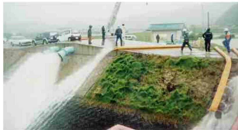
神田救急内水ポンプ稼動状況平成9年7月(高津川)
