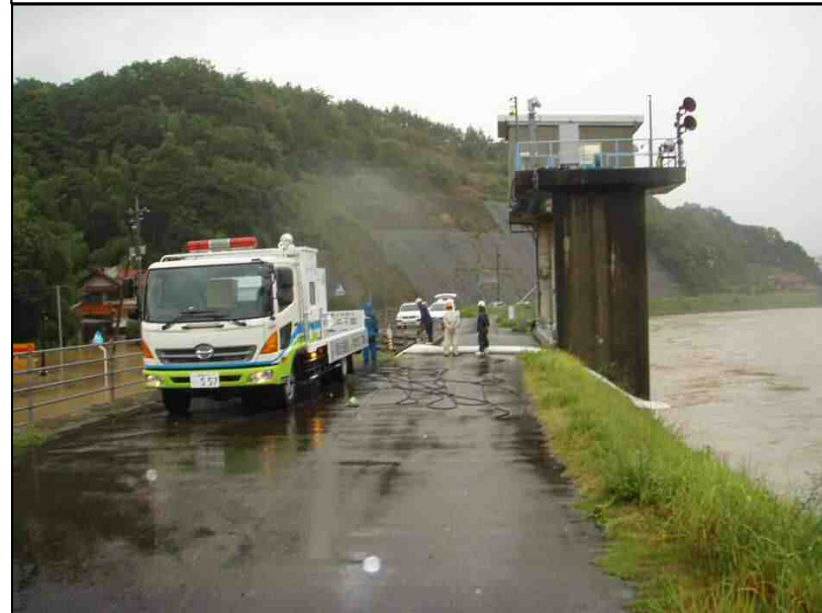
排水ポンプ車運転状況 (平成25年7月出水、南田川水門付近)
