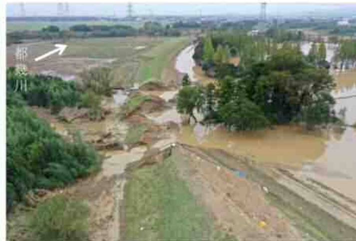
都幾川0.4k右岸 決壊箇所
