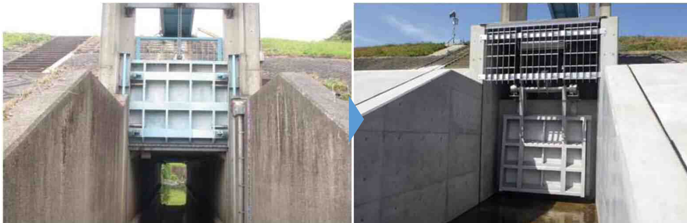
金地樋門（左：無動力化前、右：無動力化後）
