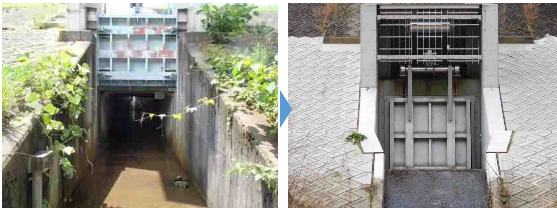
川越第5排水樋門 (左：無動力化前、右：無動力化後)
