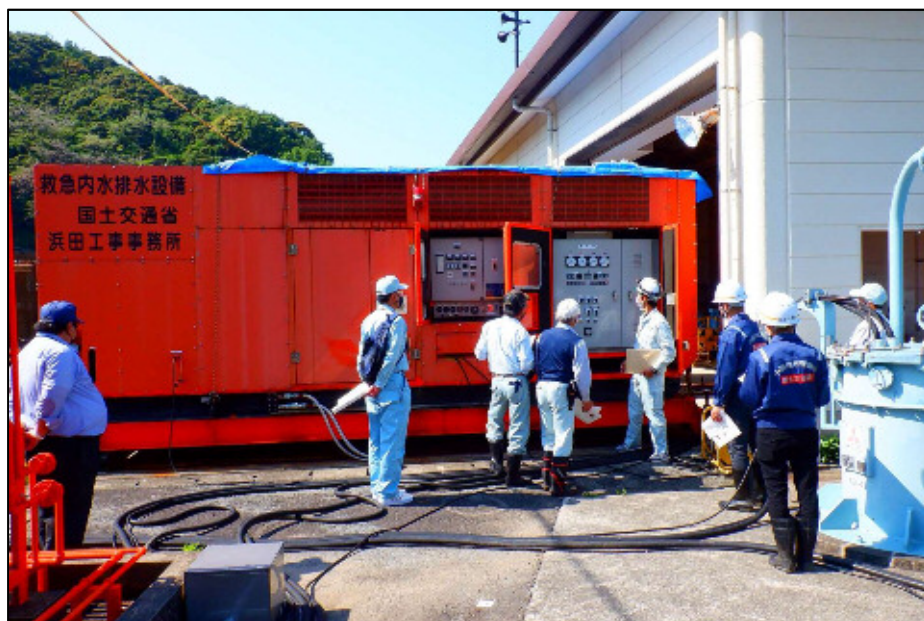
本町救急内水排水機場 操作説明会
