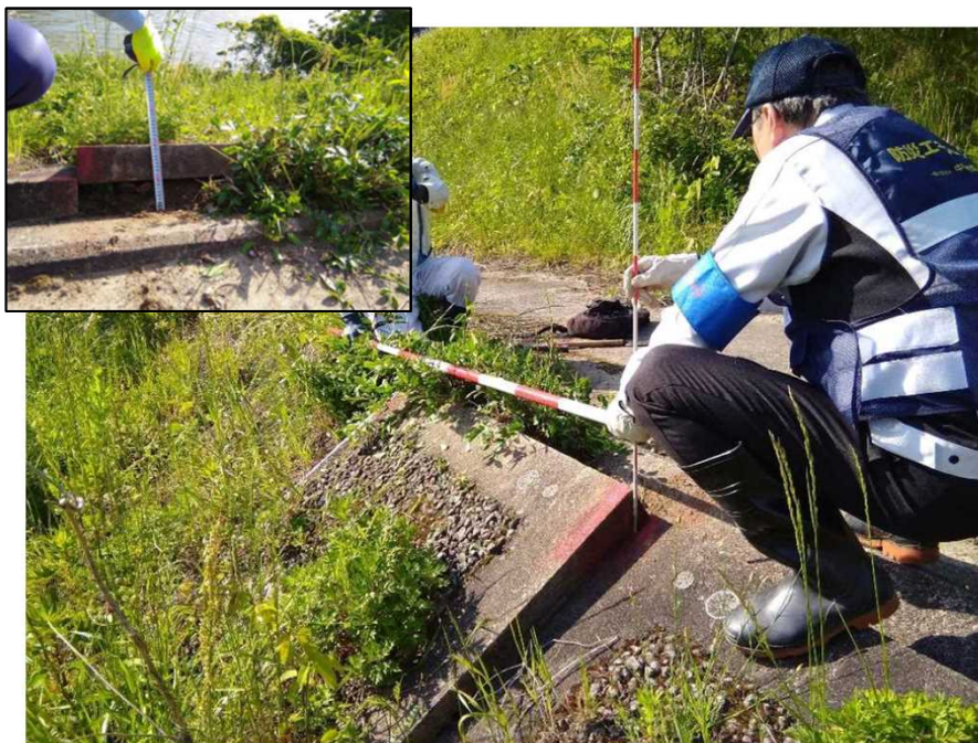
変状が見つかった堤防の様子
