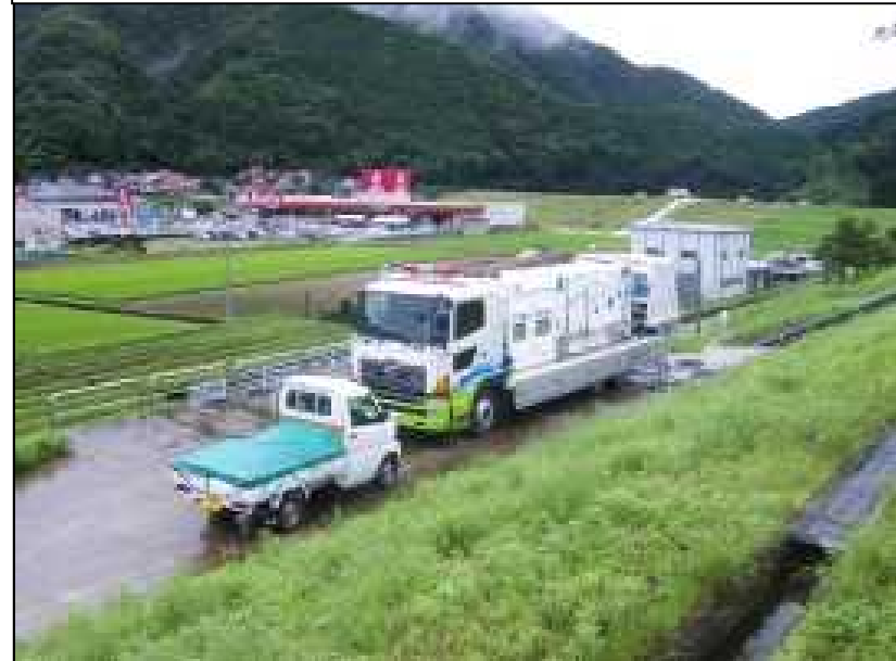
排水ポンプ車運転状況 (平成22年7月出水、因原箇所)
