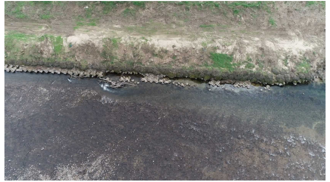
UAVによる河川巡視結果(根固工の異状)
