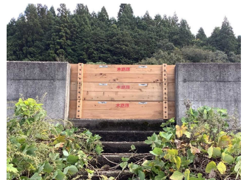
常時角落しを設置した小規模陸閘門
