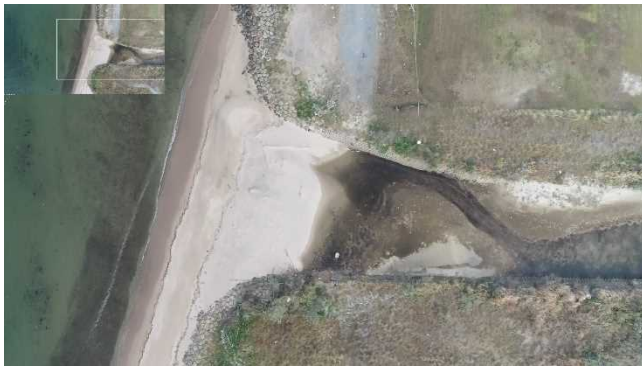
UAVによる河川巡視結果(樋門吐口部閉塞)
