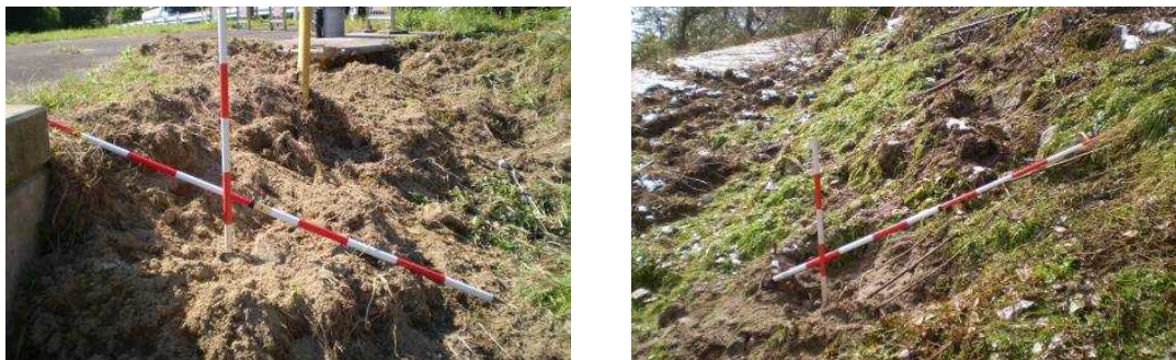
イノシシによる堤防掘り返し
