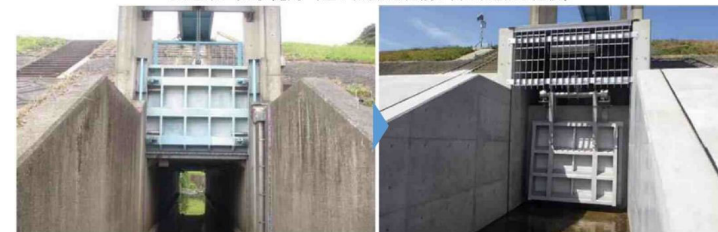
金地樋門（左：無動力化前、右：無動力化後）
