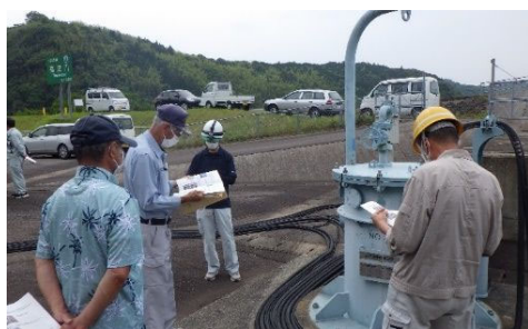
地元操作員との排水機場操作説明
