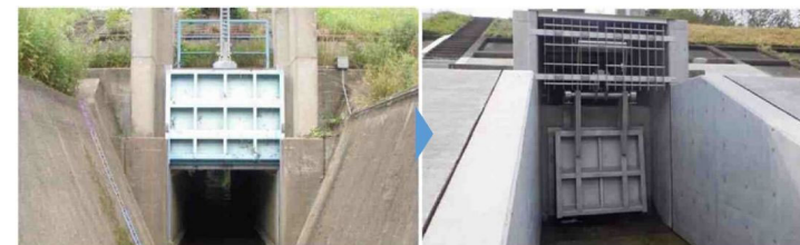
虫追第二排水樋門（左：無動力化前、右：無動力化後）
