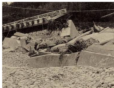
③ 昭和47年7月洪水による 派川虫追橋の被災状況
