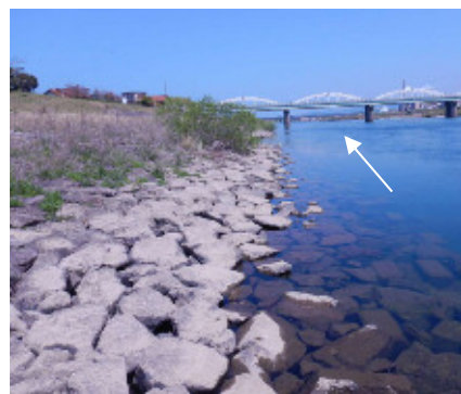
階段護岸等が未整備ため、利用しづらい水際
