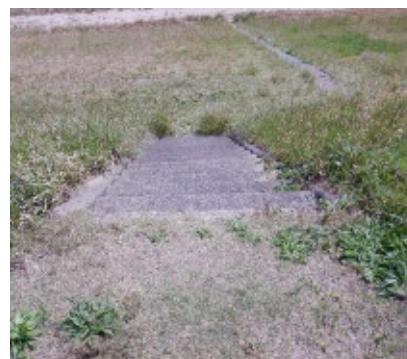
高水敷に降りるための幅が狭い階段
