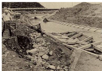
④ 昭和47年7月洪水による白上川の被災状況
