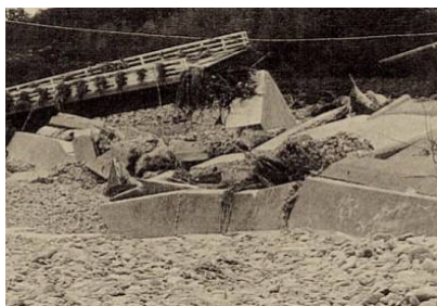
③ 昭和47年7月洪水による派川虫追橋の被災状況
