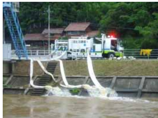
排水ポンプ車による支援活動
