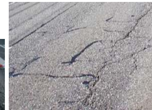
舗装のひび割れ
