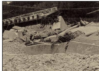
昭和47年7月洪水による 派川虫追橋の被災状況
