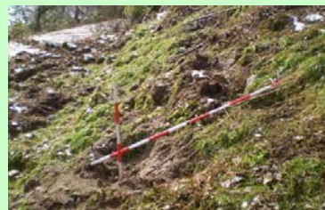
イノシシによる堤防掘り返し
