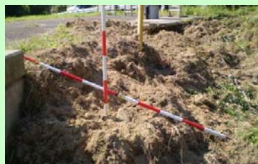
イノシシによる堤防掘り返し
