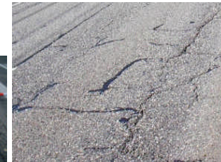
舗装のひび割れ
