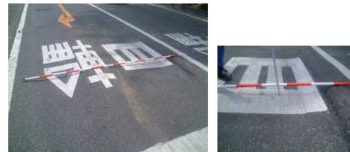
舗装のわだち掘れ
