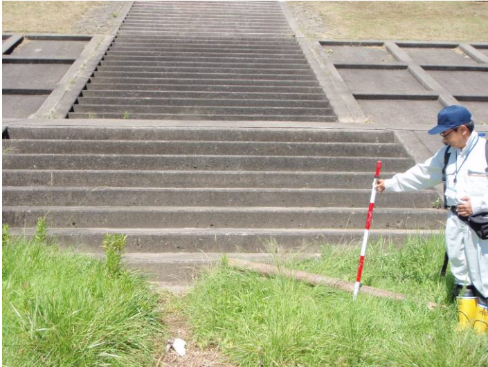
階段部の流木堆積（江津市江津町）
