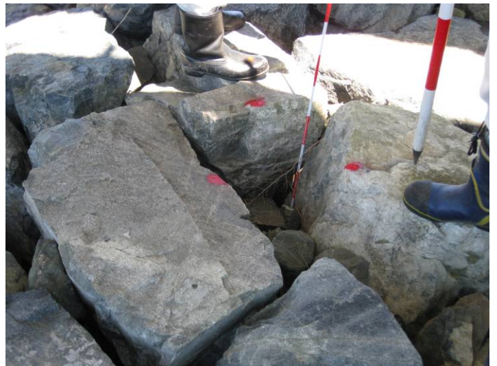
捨石護岸の隙間（江津市渡津町）新江川橋付近
