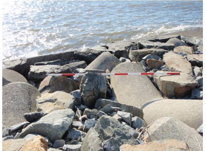
捨石の流出（江津市渡津町）江の川河口部
