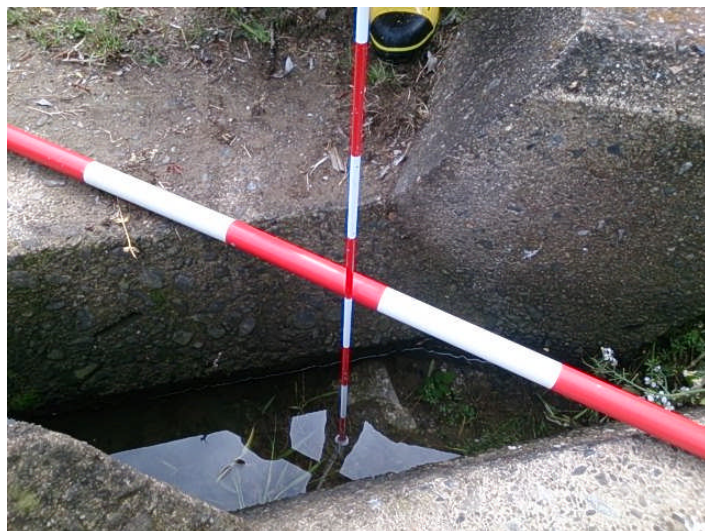
捨石一部流出（益田市高津町）
