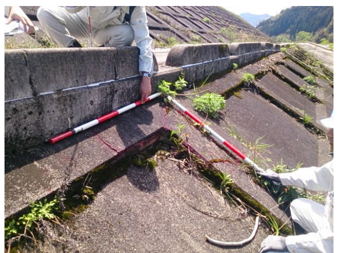
堤防護岸のひび割れ （邑智郡美郷町都賀本郷）
