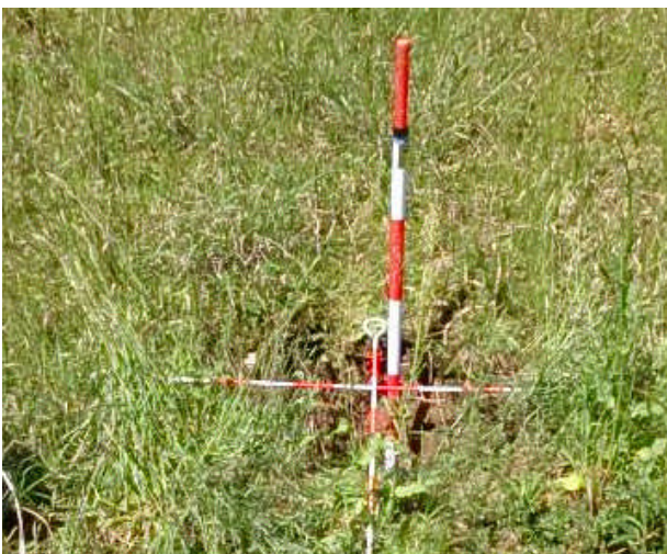
小動物による堤防の掘り起こし （邑智郡川本町川本）
