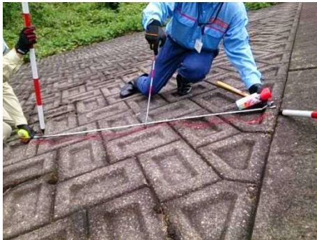
護岸のひび割れ(益田市神田町)
