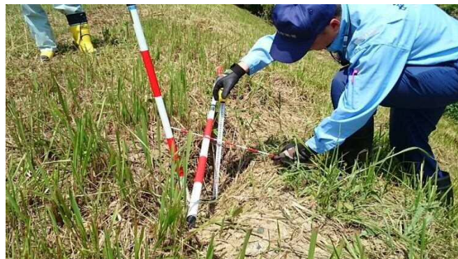
小動物等による堤防の掘り返し (益田市虫追町)
