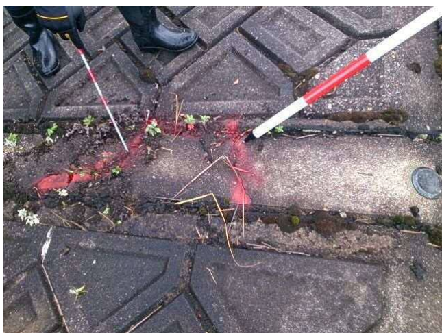
コンクリートのひび割れ等 (益田市向横田町)
