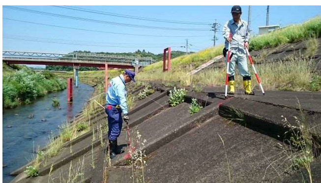
法枠護岸にひび割れ等 (益市内田町)
