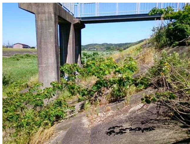
樹木の繁茂等 (益田市飯田町)
