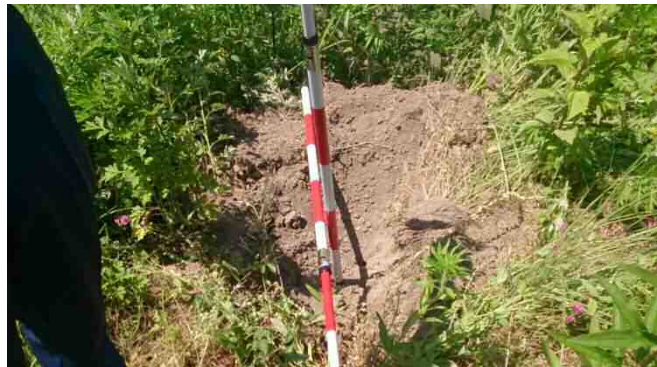
小動物等による堤防の掘り返し ( 江津市桜江町 )
