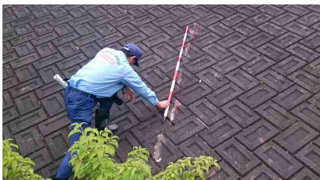
護岸にひび割れ等 ( 邑智郡美郷町 )
