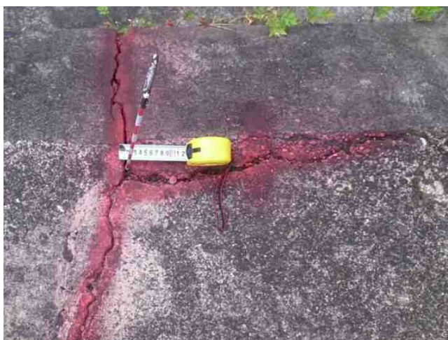
コンクリートのひび割れ等 ( 邑智郡川本町 )
