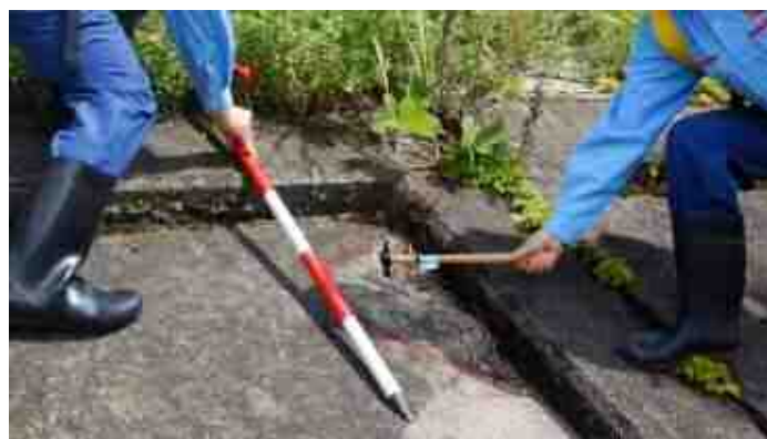
コンクリートのひび割れ等 (邑智郡美郷町)
