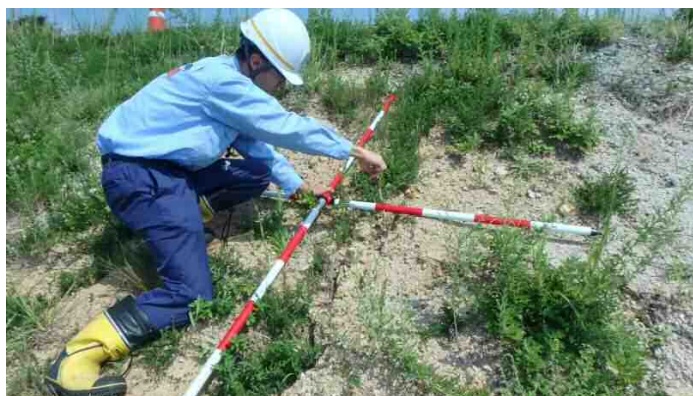
動物等による堤防の掘り返し (江津市江津町)
