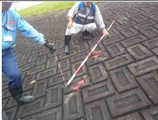
護岸のひび割れ等 (益田市飯田町)
