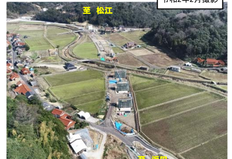
写真① 出雲・湖陵道路 常楽寺第2高架橋(仮称)付近の工事の様子
