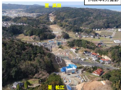
写真② 大田・静間道路 久手高架橋(仮称)付近の工事の様子
