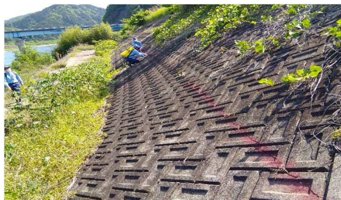
コンクリートのひび割れ等 (邑智郡川本町)
