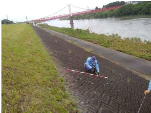
張ブロックのひび割れ等 (益田市飯田町)
