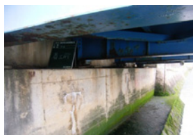
落橋防止装置（設置前）
