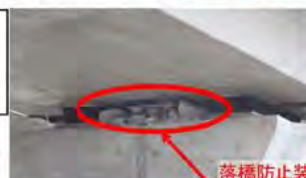
落橋防止装置
