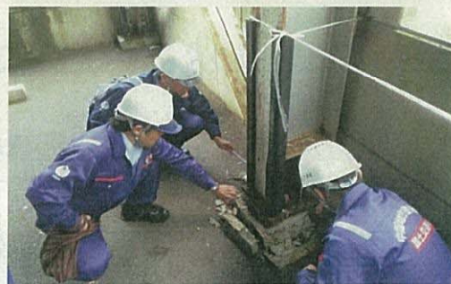
公共建築物の被災状況調査(東伯郡三朝町)
