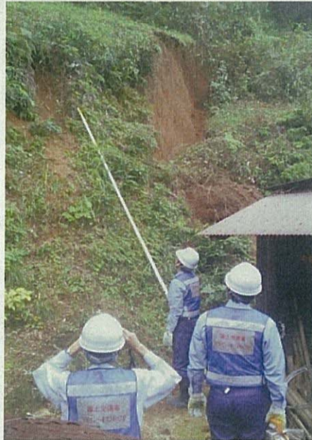
法面の被災状況調査(東伯郡三朝町)
