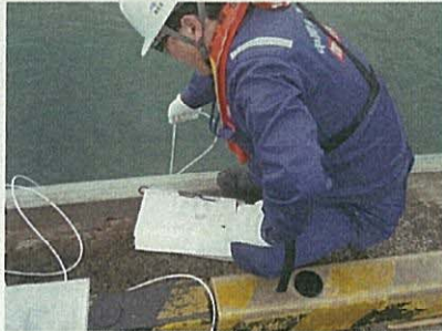
赤碕港の被災状況を調査(東伯郡琴浦町)
