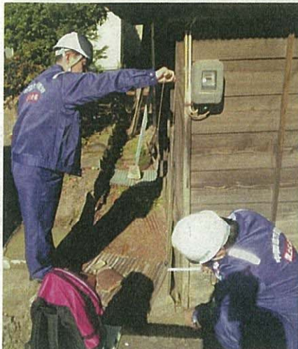
民間住宅等の応急危険度判定 (東伯郡北栄町)
