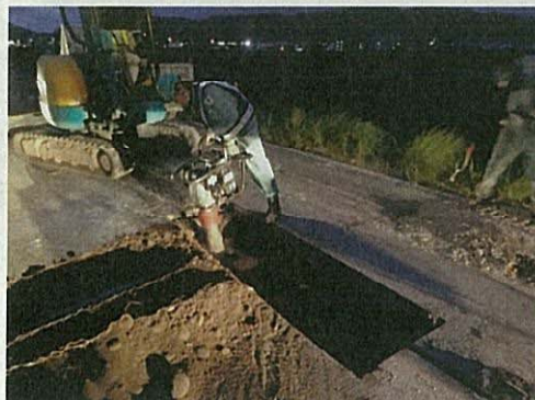
天神川水系小鴨川応急対策状況(倉吉市)
