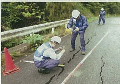
道路の被災状況調査(東伯郡湯梨浜町)
