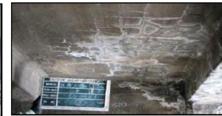
床版ひびわれ
