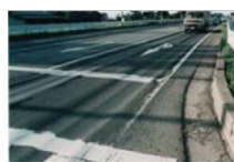
(舗装のわだち掘れ)
