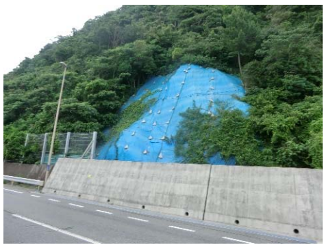
▲ 土砂災害被災状況
