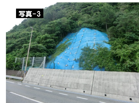
▲ 土砂災害被災状況
