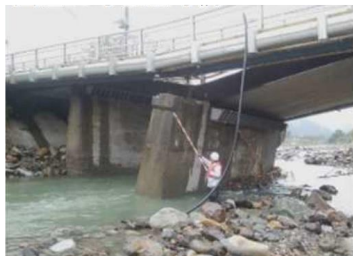
国道20号 法雲寺橋 令和元年台風19号 1ヶ月半の通行止め
