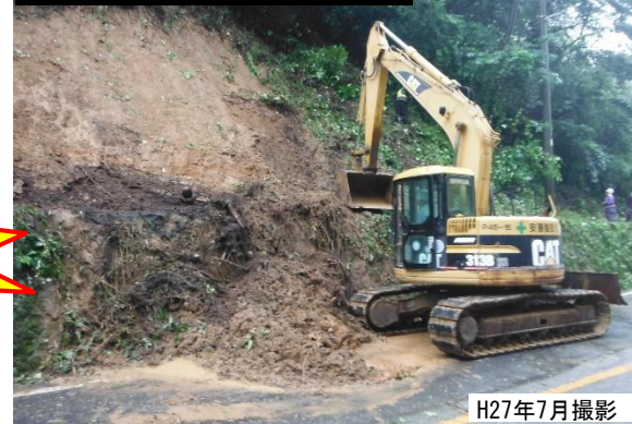
【写真③】法面崩落の状況
