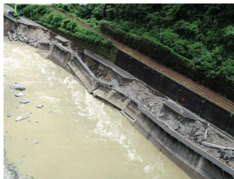
国道41号 令和2年7月豪雨 1ヶ月半の通行止め
