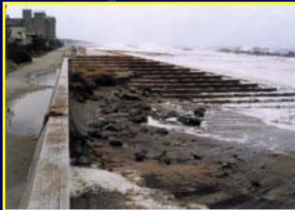
皆生工区の砂浜侵食 (平成10年9月)
