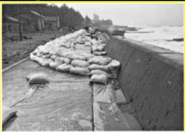
淀江堤防被災 (昭和45年1月)
