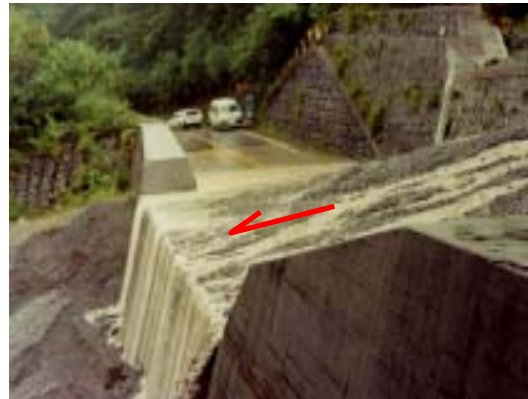
環状道路一の沢土砂流出状況
