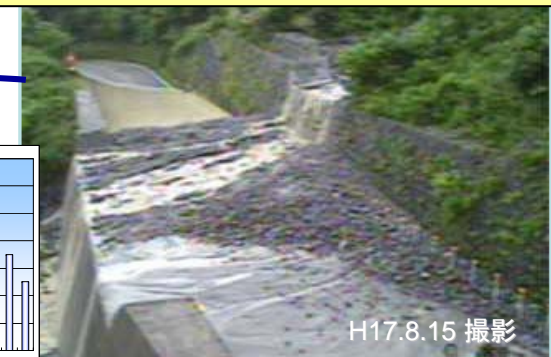
一の沢土砂流出状況(環状道路付近)
