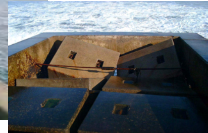
両三柳地区;吸出しによる突堤の陥没
