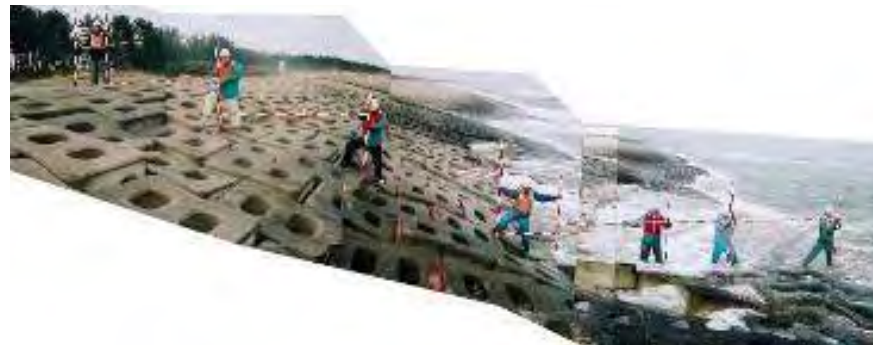
夜見地区;吸出しによる緩傾斜護岸の陥没
