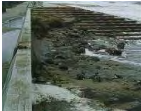
①-1 皆生地区;強波浪による緩傾斜護岸の崩壊
