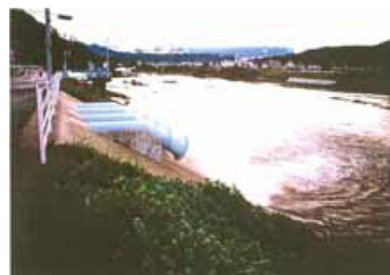
平成10年10月台風洪水 倉吉市和田地区の排水機場稼働状況
