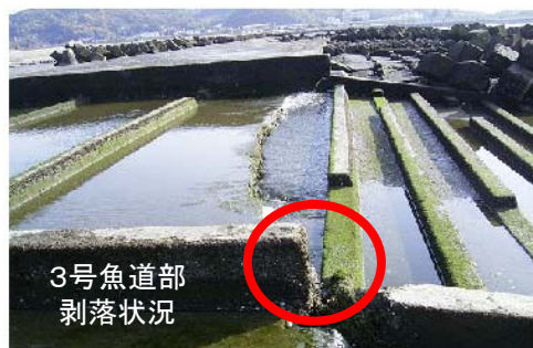
魚道老朽化状況
