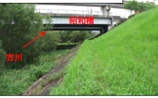
河川利用者が河川内で移動できない
