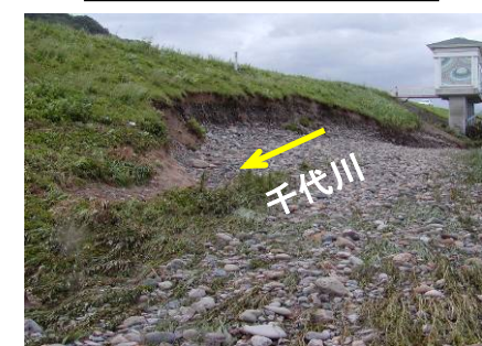
鳥取市倉田地区の被災状況
