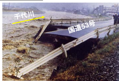
国道が侵食により流出(旧用瀬町)
