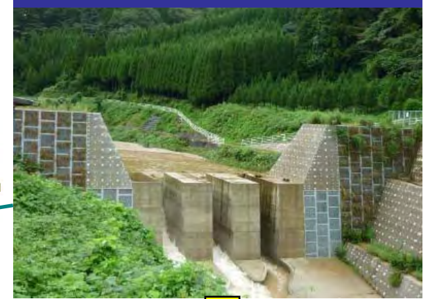
下畑砂防堰堤の捕捉状況
