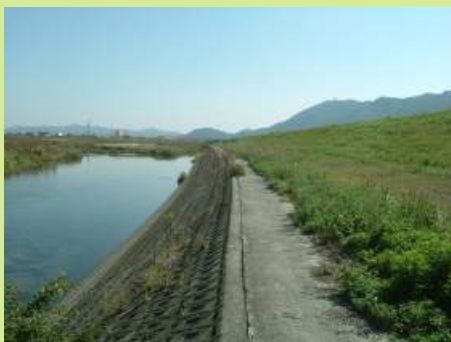
水辺に近づきにくい護岸 (19k000付近)
