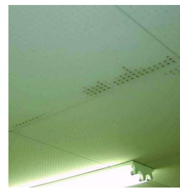
天井漏水(老朽)
