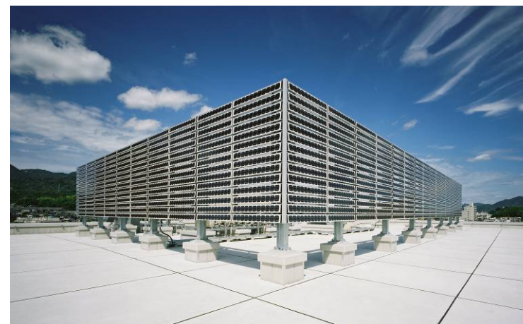
屋上の太陽光発電
