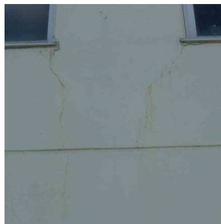
外壁(ひび割れ)
