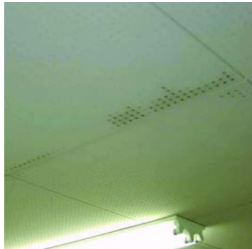
天井漏水（老朽）
