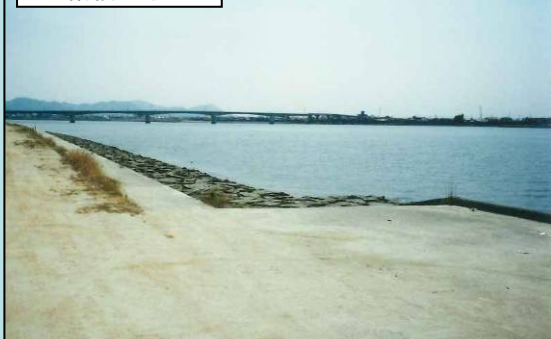
護岸が急勾配なため水辺に近づきにくい
