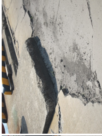
エプロンの段差
