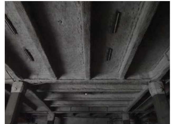
上屋の内装材の石綿確認箇所 ※被覆材下の部材に石綿を確認
