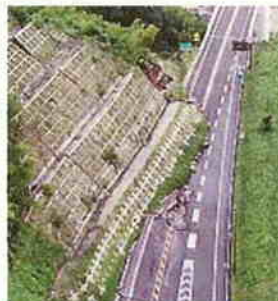
▲豪雨による道路被害 (山陰道 H18.7)
