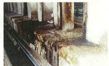
▲アスファルトラインにおける漏水腐食進行
