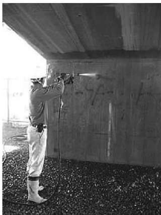
国道 2 号線橋脚でのケイ酸アルカリ含浸施工テストの様子
