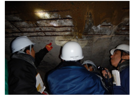
現地実習(損傷状況の確認)
