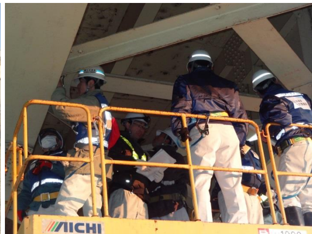
損傷内容確認状況
