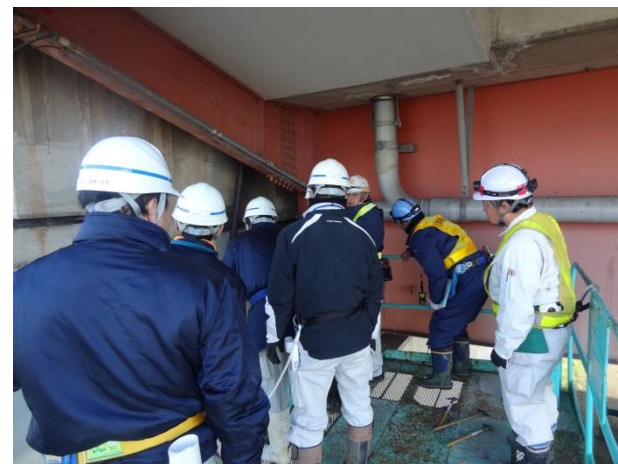
損傷内容確認状況
