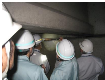
損傷確認状況
