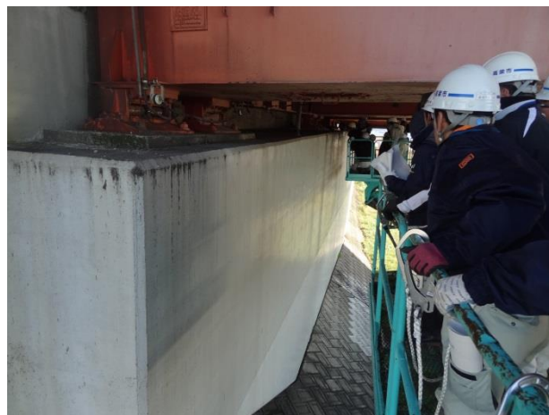
損傷内容確認状況
