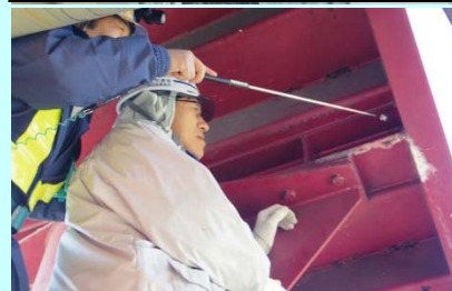
鋼板腐食状況及び水みち確認
