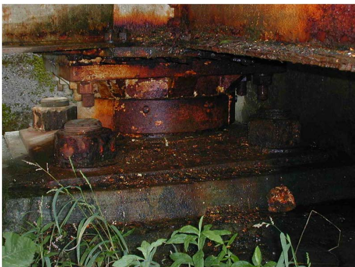
支承の損傷（腐食）
