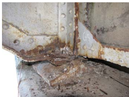
主桁の損傷 （腐食）
