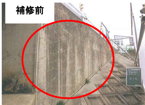
橋台の損傷 （コンクリートのひびわれ）
