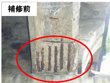
主桁の損傷 （下面の鉄筋が露出）
