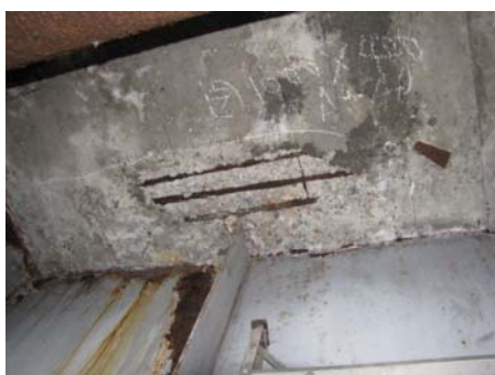
床版の損傷 （コンクリート剥離・鉄筋露出）
