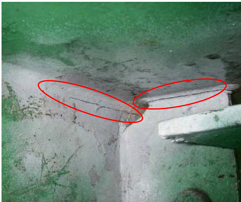
主桁の鋼部材に発生した疲労亀裂
