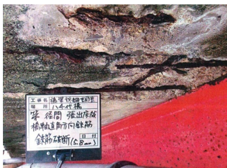
床版下部の損傷
