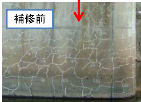
橋脚の損傷（ひびわれ）
