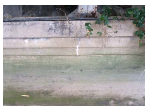
橋台の損傷 （ひび割れ）
