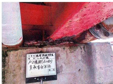
支承・主桁の損傷
